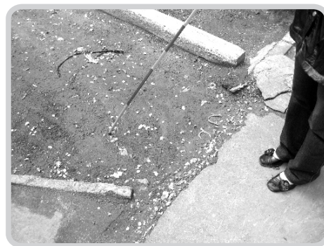
Рис. 19. Отсутствие ограждающего бордюрного камня вдоль тротуара
