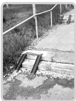
Рис. 66. Ненормативный пандус, опасный для незрячих и слабовидящих, находится на пути от остановки скоростного трамвая «Водоотстой»
