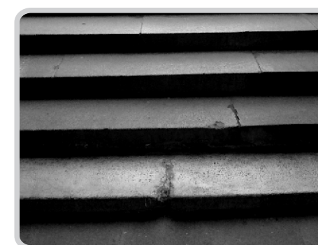
Рис. 56. Контрастная окраска крайних ступеней лестничного марша в подземном переходе в г. Москве
